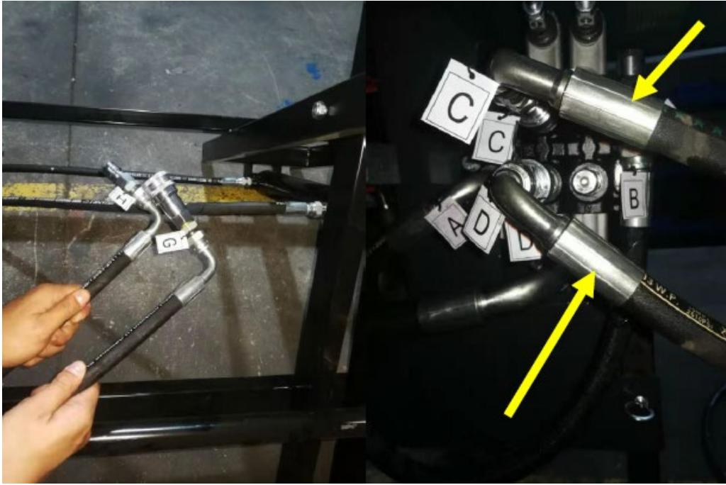
H/G – conexão do cilindro do elevador de toras para o motor do elevador.
